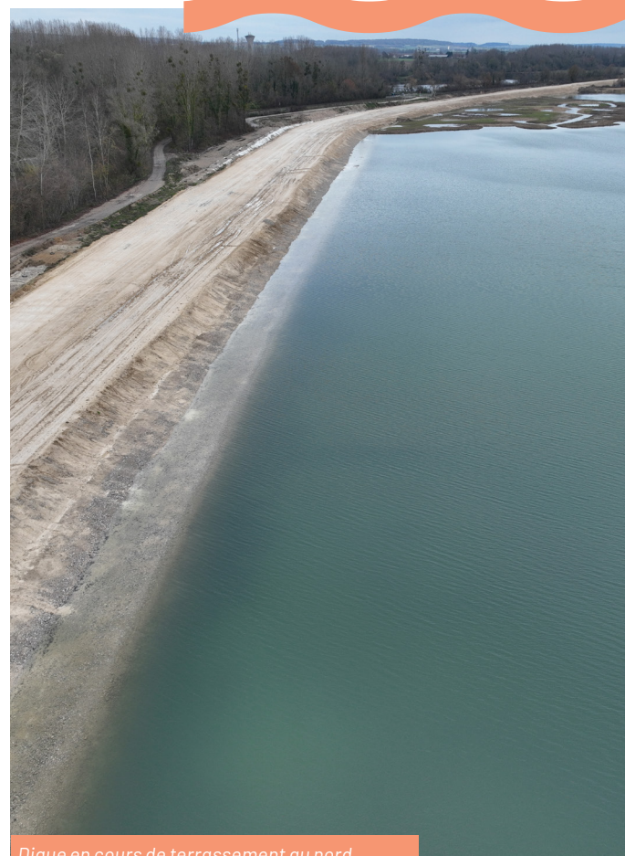
Digue en cours de terrassement au nord du site, sur les bords de l'étang de la Bachère
