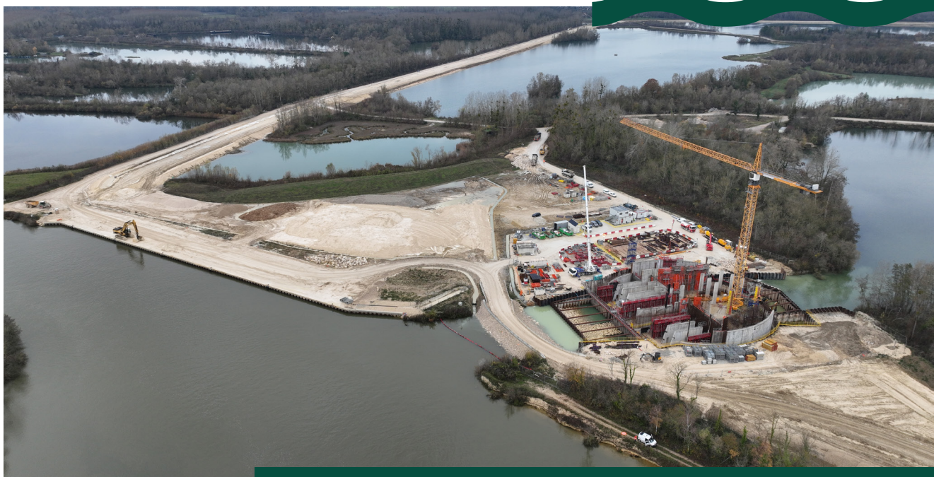
Vue de la future digue et de la station de pompage principale, sur le secteur sud-ouest du site pilote
